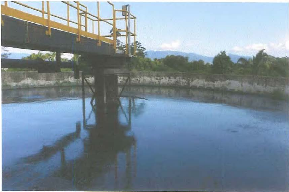
Foto 55: Sistema Esgotamento Sanitário (SES) Indaiá – Estação de Tratamento de Esgotos (ETE) Indaiá – Adensador de Lodo.
