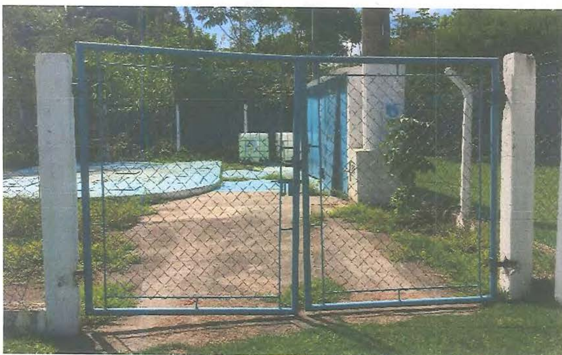
Foto 59: Sistema Esgotamento Sanitário (SES) Massaguaçu – Estação Elevatória de Esgotos (EEE) Final Massaguaçu.
