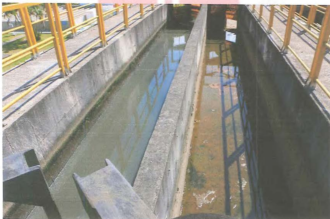
Foto 58: Sistema Esgotamento Sanitário (SES) Martin de Sá – Estação de Tratamento de Esgotos (ETE) Martin de Sá – Caixas de Areia.
