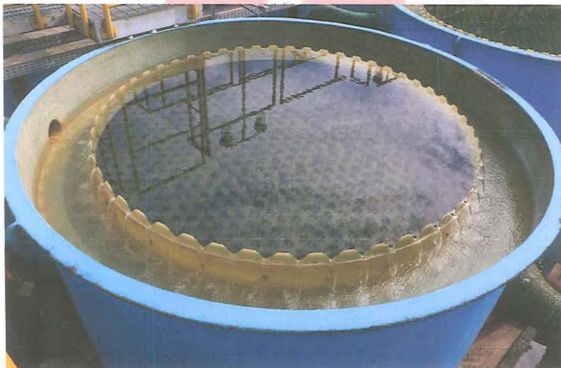
Foto 18: Sistema Guaxinduba – ETA – Decantador de Fluxo Lamelar.
