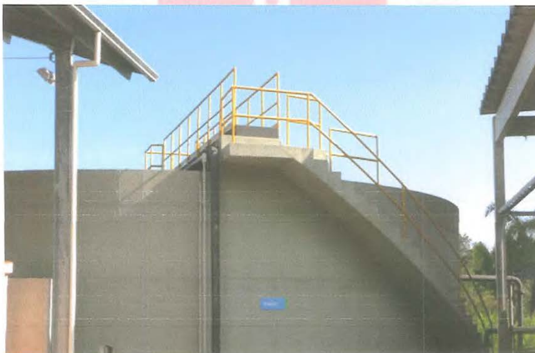
Foto 54: Sistema Esgotamento Sanitário (SES) Indaiá – Estação de Tratamento de Esgotos (ETE) Indaiá – Adensador de Lodo.
