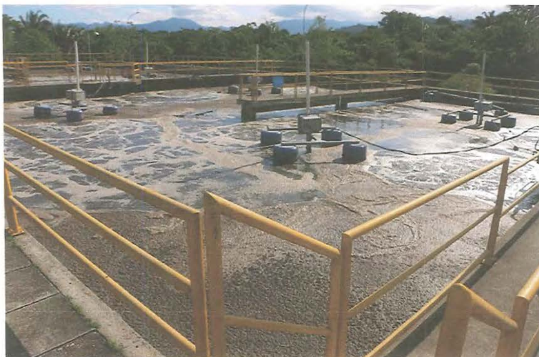
Foto 53: Sistema Esgotamento Sanitário (SES) Indaiá – Estação de Tratamento de Esgotos (ETE) Indaiá – Aeradores Mecanizados Superficiais.
