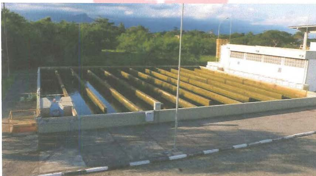
Foto 50: ETE Porto Novo – Tanque de Contato.
