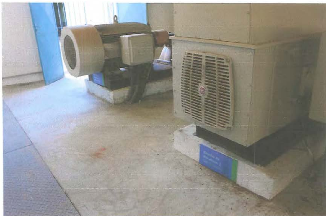
Foto 9: Sistema Porto Novo - EEPE5 (para São Sebastião).
