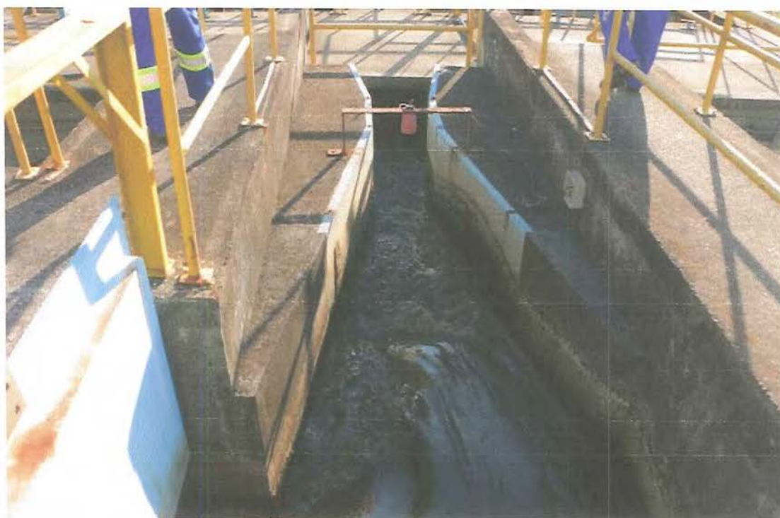
Foto 47: ETE Porto Novo – Medidor Parshall.
