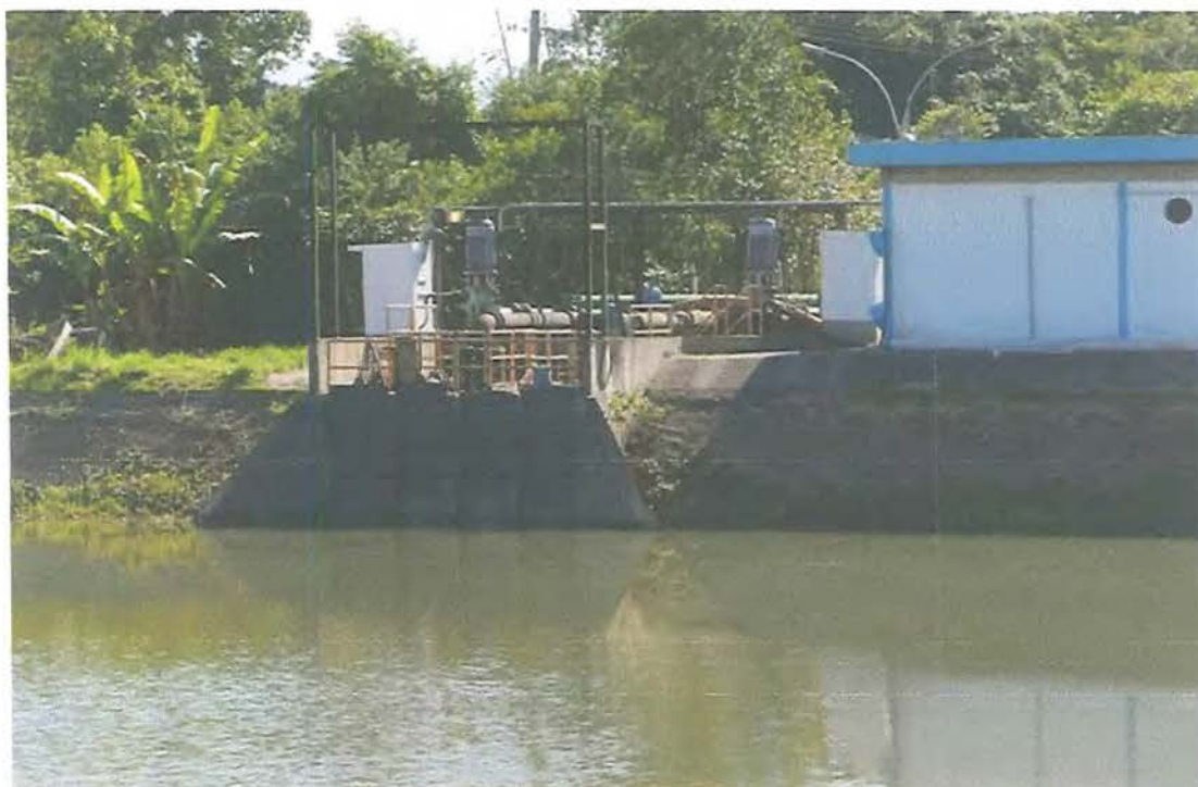
Foto 3: Sistema Porto Novo - Estação Elevatória de Água Bruta EEAB Baixo Rio Claro.
