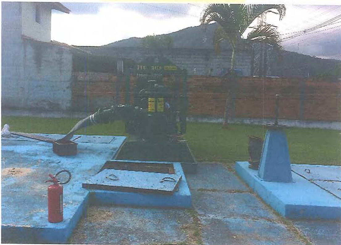
Foto 52: Sistema Esgotamento Sanitário (SES) Indaiá – Estação Elevatória de Esgotos (EEE) Final Tinga-Poiães.
