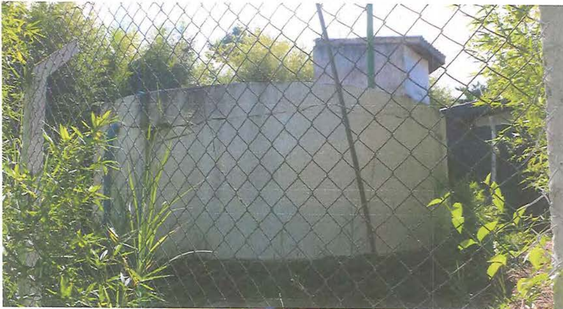
Foto 27: Sistema Massaguaçu – Reservatório Roteiro do Sol, capacidade 100m 3 .
