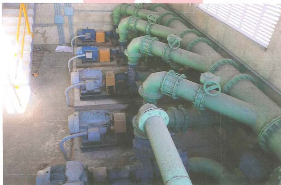
Foto 10: Sistema Porto Novo – EEAT Palmeiras Norte.
