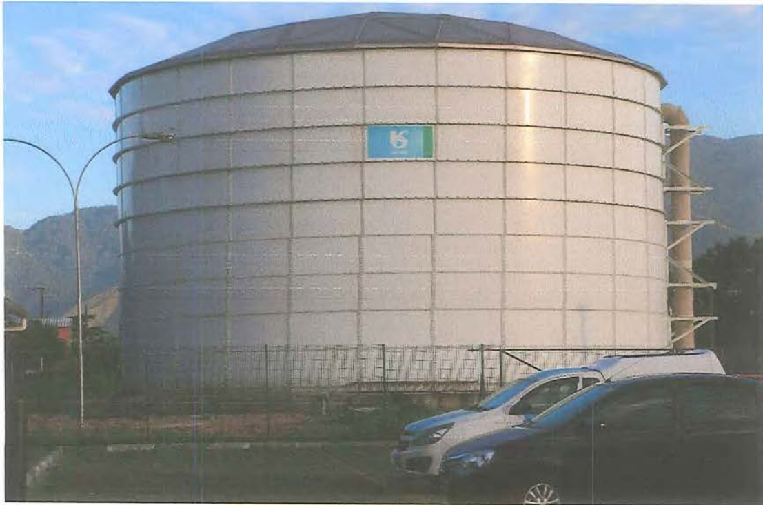
Foto 11: Sistema Porto Novo – Reservatório RPN-2.
