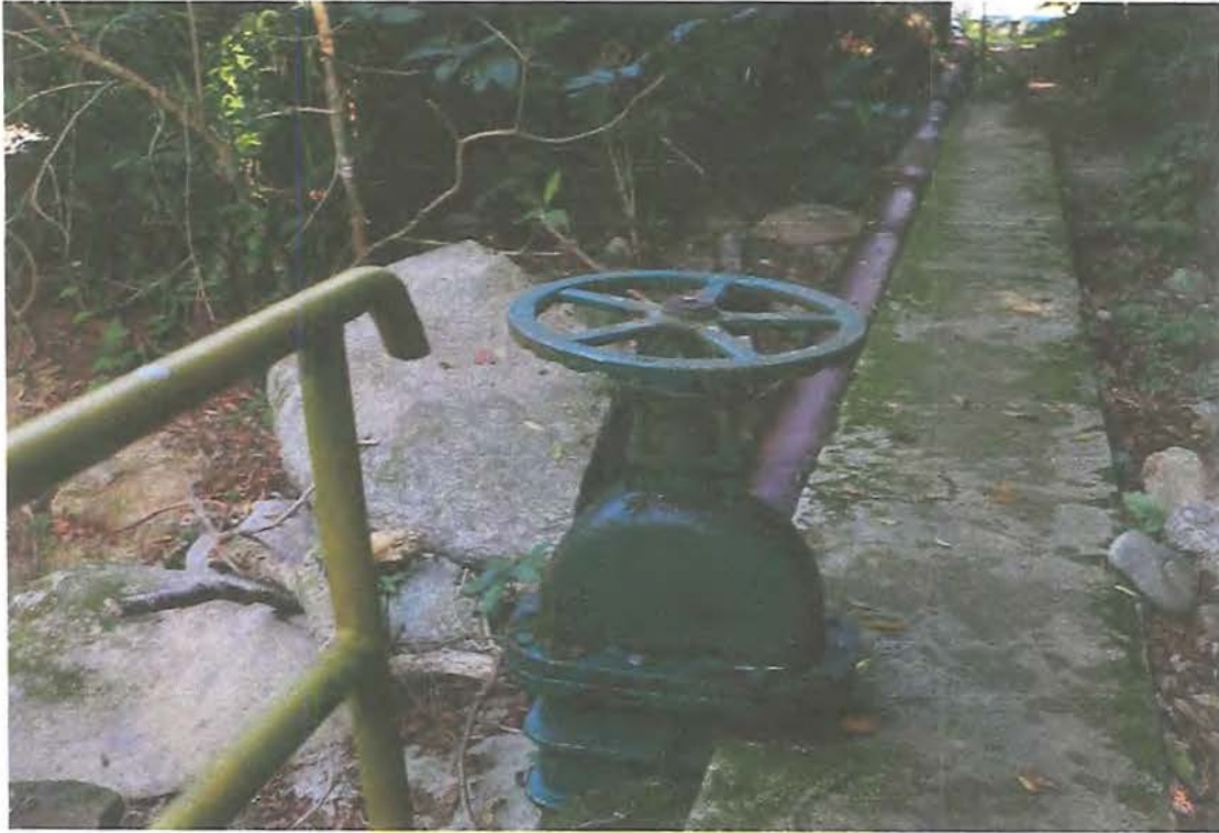
Foto 13: Sistema Guaxinduba – Adutora de Água Bruta (AAB).
