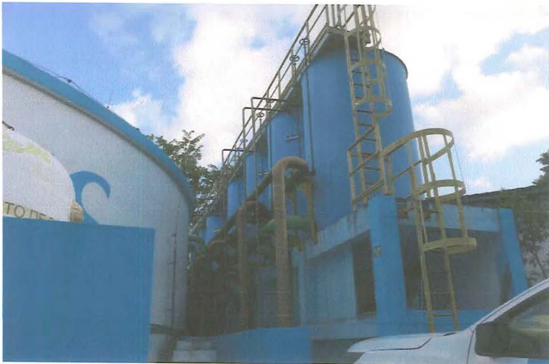
Foto 25: Sistema Massaguaçu – ETA Massaguaçu – Sistema de Filtros.
