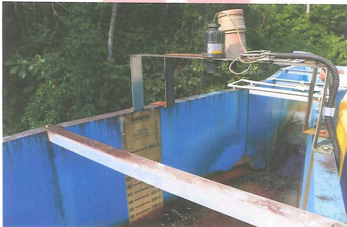
Foto 16: Sistema Guaxinduba – ETA – Calha "Parshall" Coagulação do Tipo Hidráulica.
