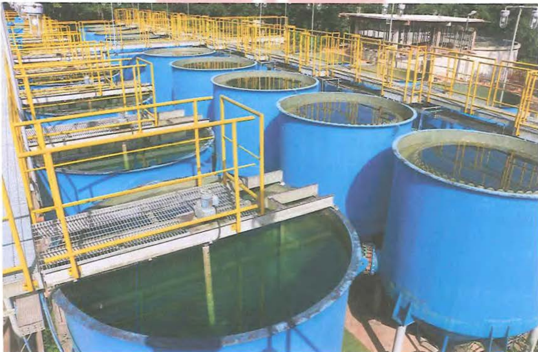
Foto 14: Sistema Guaxinduba – Vista Geral Estação de Tratamento de Água (ETA) Guaxinduba.
