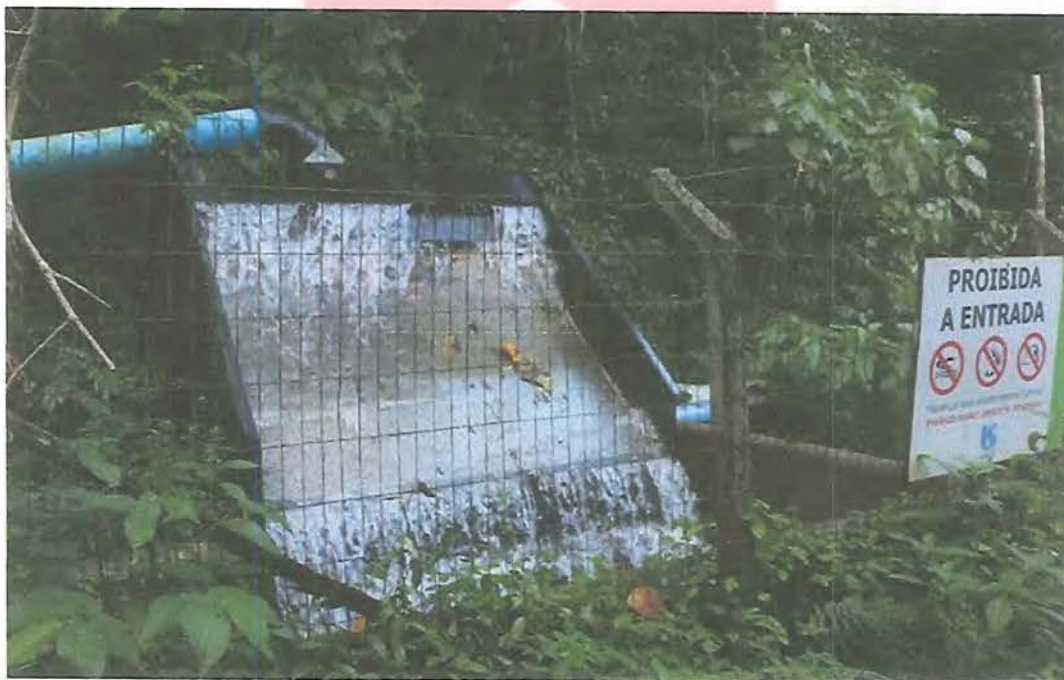
Foto 24: Sistema Massaguaçu – Captação Rio Mococa – Peneira Estática.
