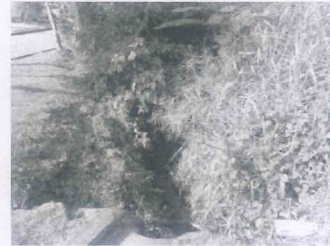
Foto 02 – Trecho próximo a Rua Bonito. Com detalhe para a falta de conformação e assoreamento da vala.
