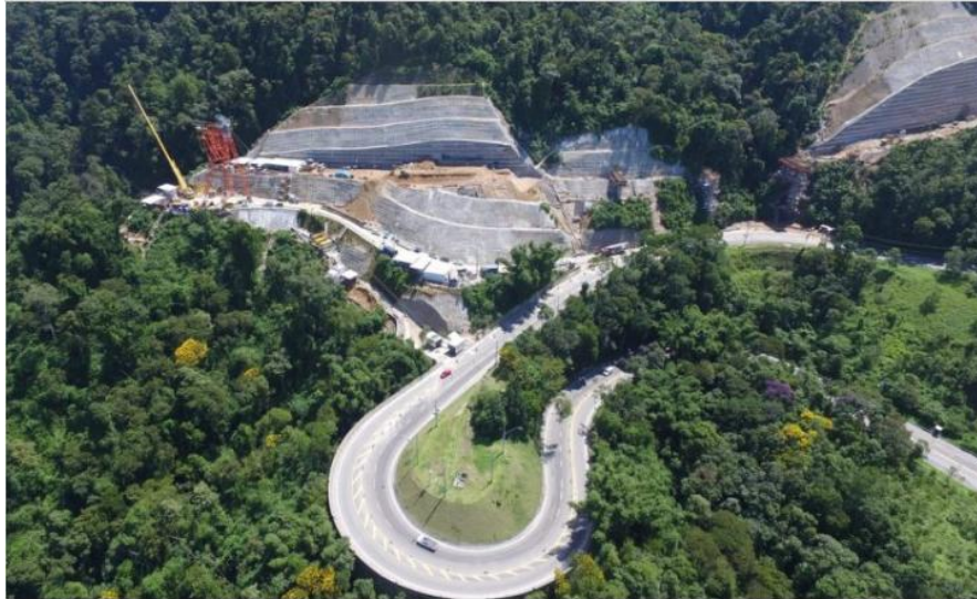
Trecho em obras na rodovia, que liga o Vale do Paraíba ao Litoral Norte; entrega adiada (Foto: Divulgação Tamoios)
