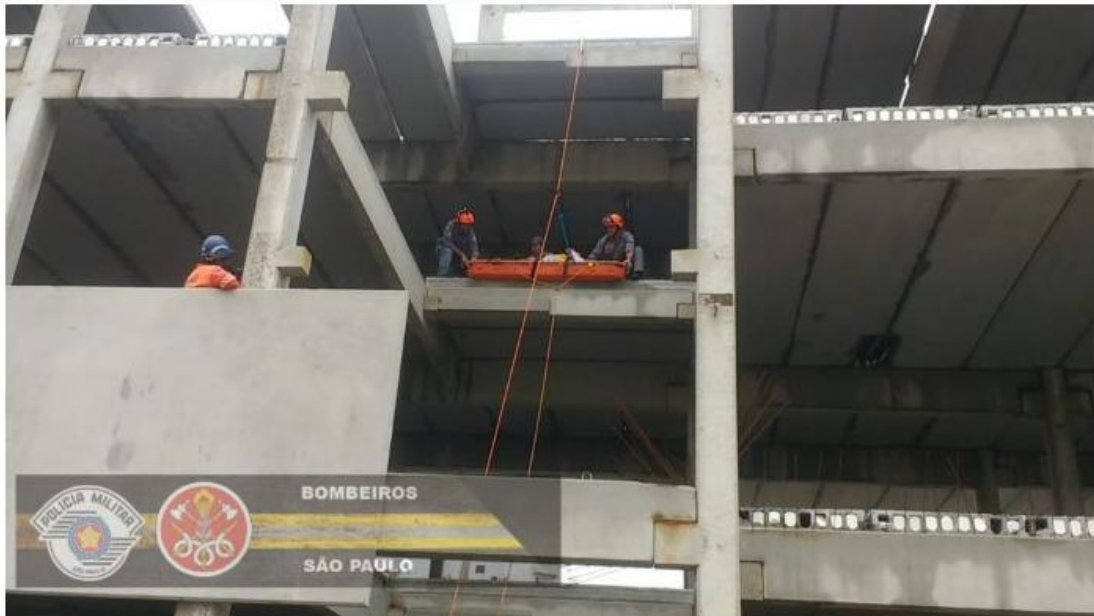
Bombeiros p o reparam descida de operário acidentado em prédio (Fotos: Divulgação)
