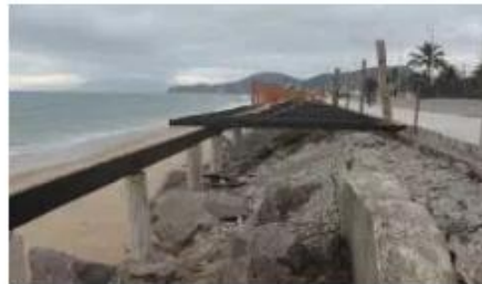
Danos provocados pela ressaca em 2017
