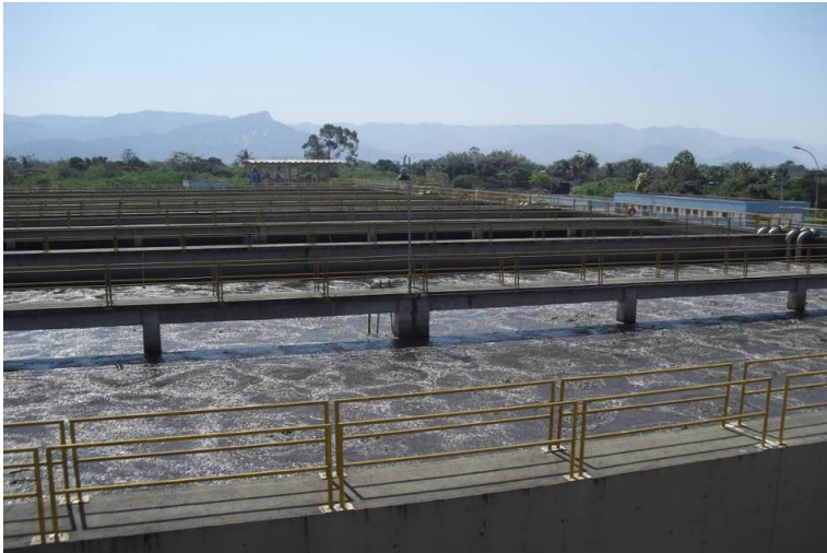
Foto 23 – Tanques de Aeração da ETE Porto Novo
