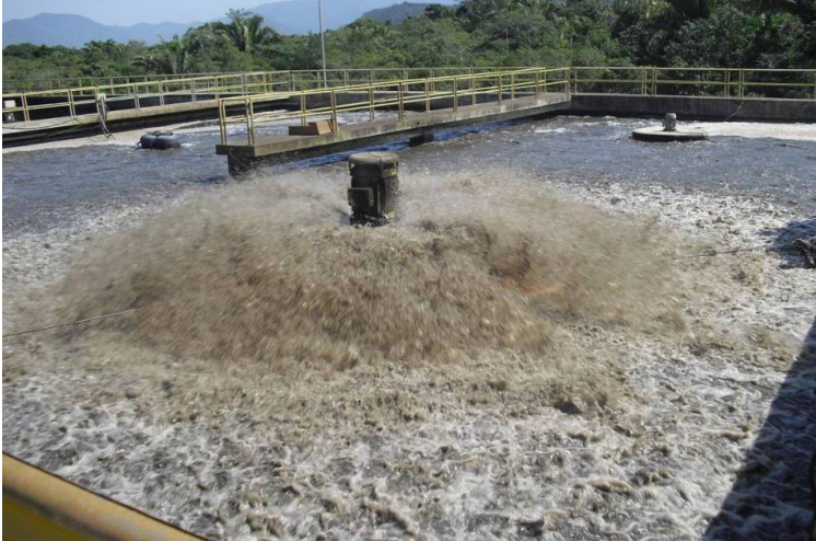
Foto 25 – Tanques de Aeração/Sedimentação da ETE Indaiá
