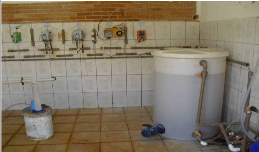
Foto 16 – Sistema de Aplicação de Cloro e Flúor
